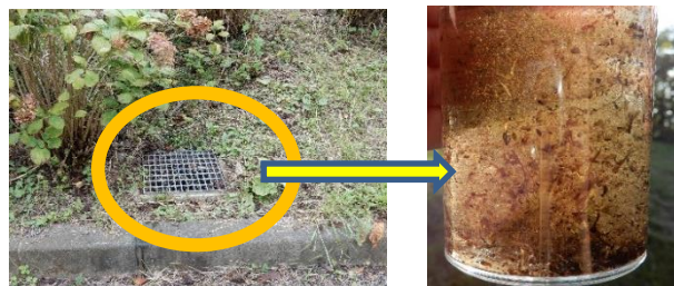
公園内の雨水枡 中には落ち葉が堆積していた
